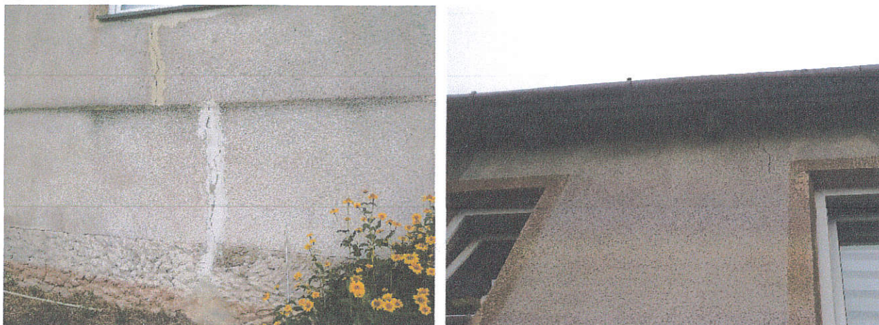
Widok zarysowań ścian budynku mieszkalnego
