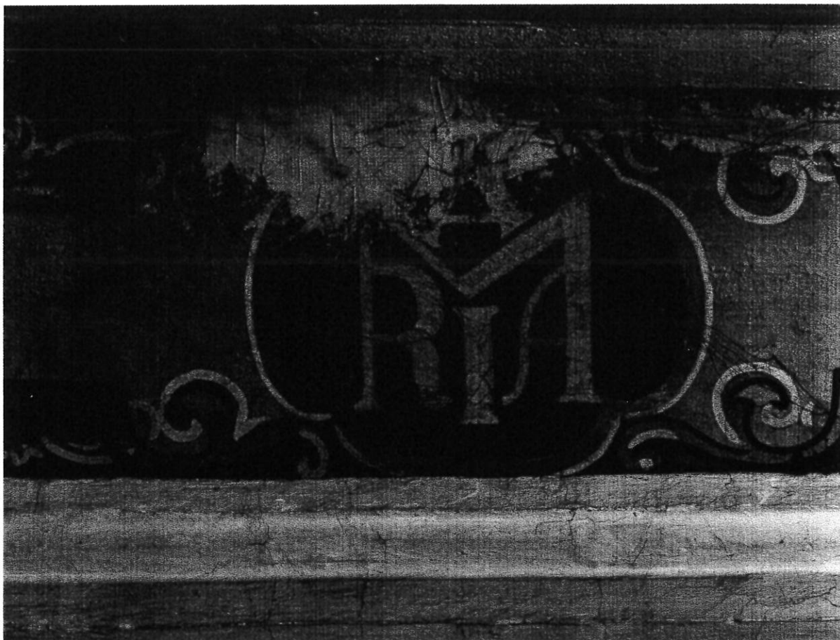
Polichromie ścienne w kościele pw. Świętej Trójcy w Kłótnie, widoczne ubytki warstwy malarskiej na fasacie sklepienia. Widoczne nieprofesjonalne naprawy wykonane gipsem.
