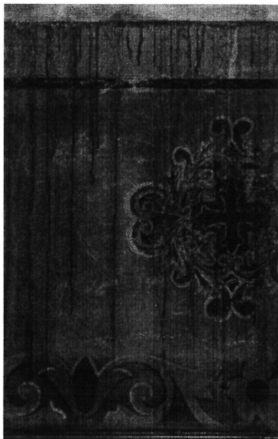
Polichromie ścienne w kościele pw. Świętej Trójcy w Klótnie - widoczne zacieki wody spływającej z parapetów okien.
