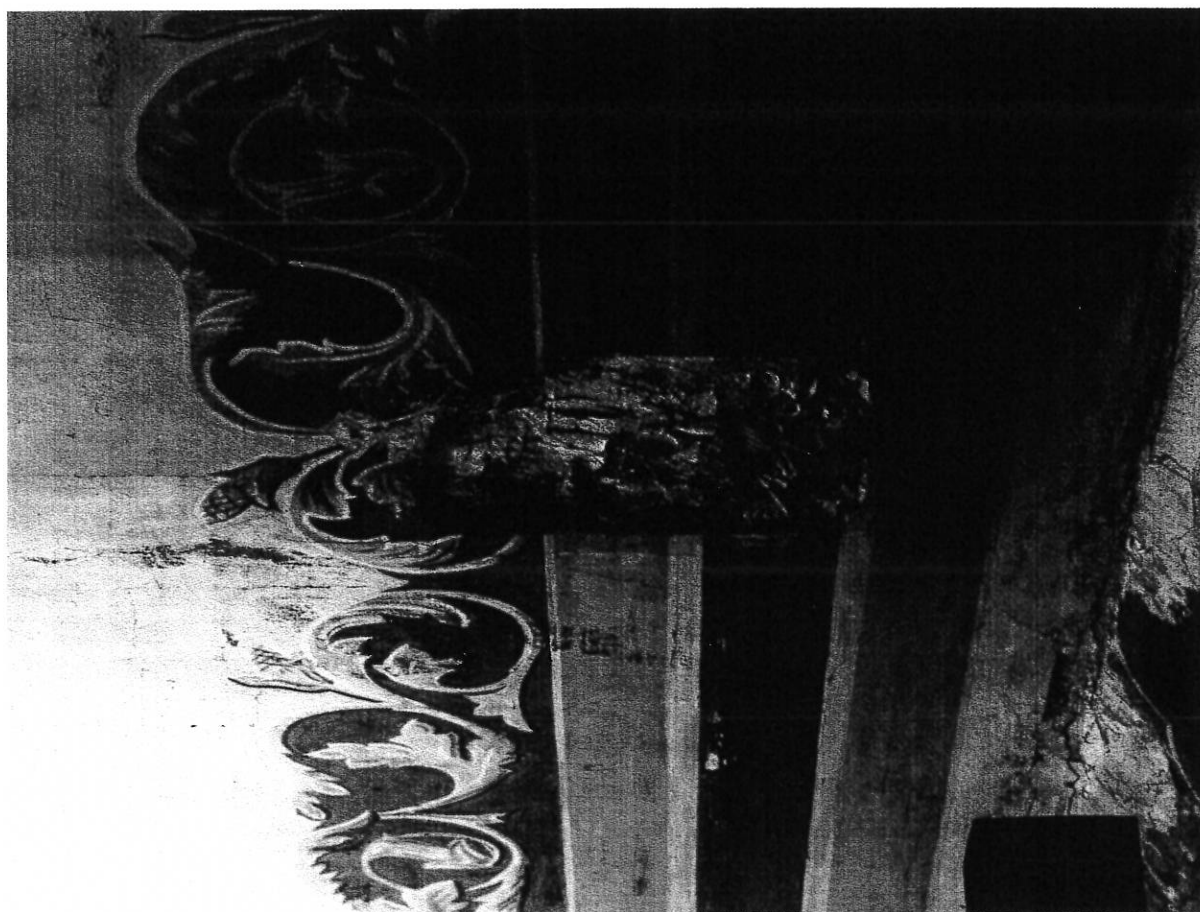
Polichromie ścienne w kościele pw. Świętej Trójcy w Kłótnie, widoczne spękania i ubytki tynku na suficie.
