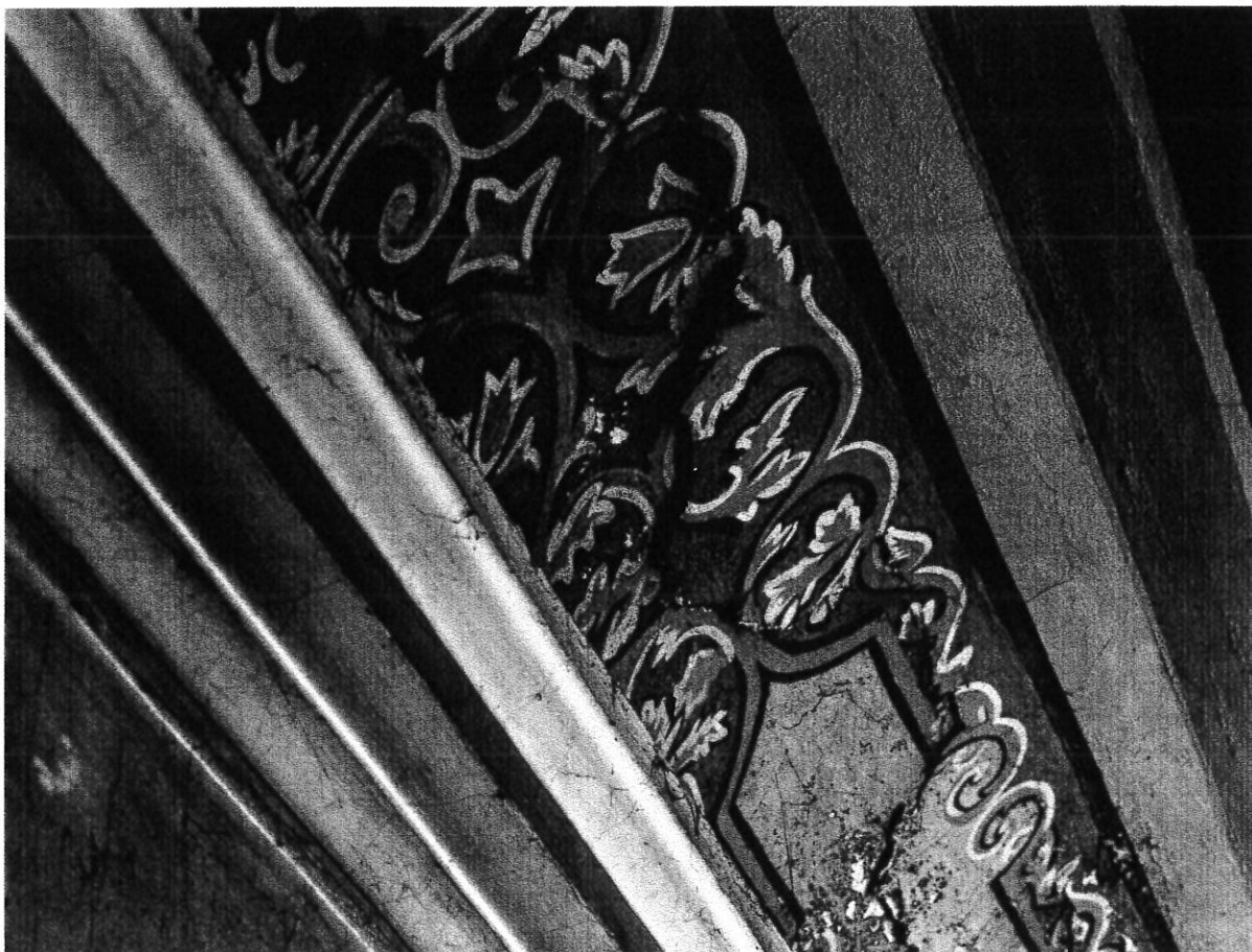
Polichromie ścienne w kościele pw. Świętej Trójcy w Kłótnie, widoczne pęknięcia z przemieszczeniem na fasacie sklepienia.
